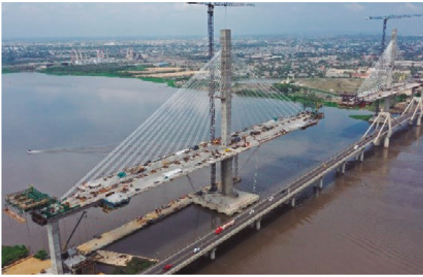
Figura 40. Vista de los carros de avance por voladizos sucesivos y los carros de alas 3 dovelas por detrás.
