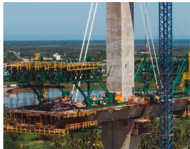
Figura 37. Ejecución de las dovelas cajón 2 una vez dispuestas las primeras 2 parejas de tirantes de cada lado y liberado el empotramiento provisional contra el pylon.
